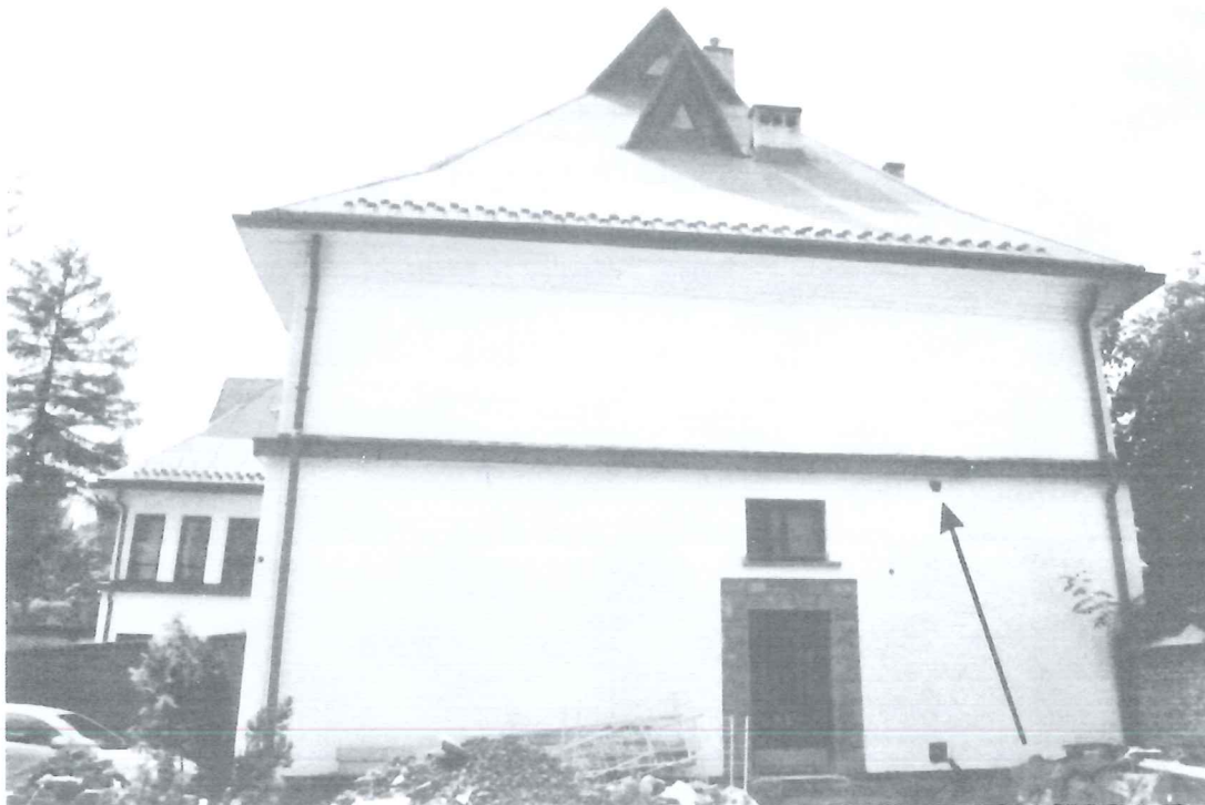
Fot 5. Ściana wschodnia Domu Pielgrzyma. Zaznaczono niezakratowane okienko wentylacyjne - potencjalne siedlisko ptaków. (stan na dzień 1.08.2019).
